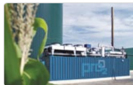
Instalação de biogás Steinfurt
