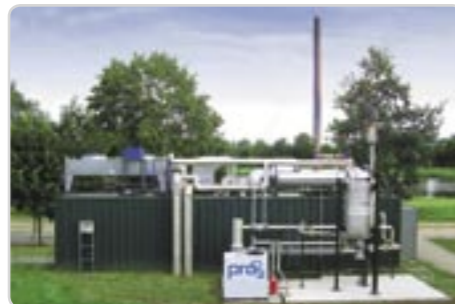
Биогазовая БТЭС с системой газоочистки г. Кляйнбауцен
